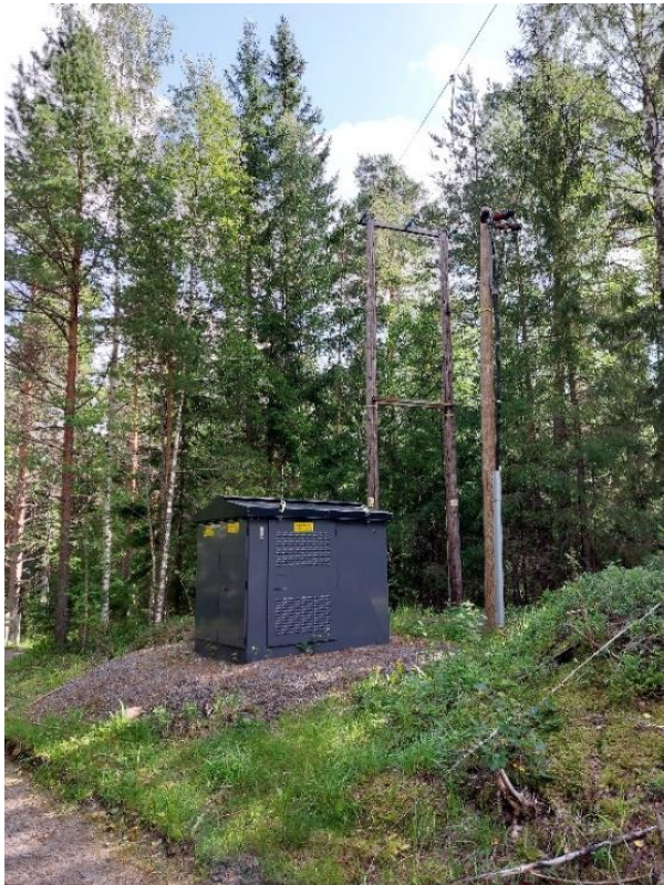
Kuva 10-1. Puistomuuntamo Santakosken pohjavesialueella.
