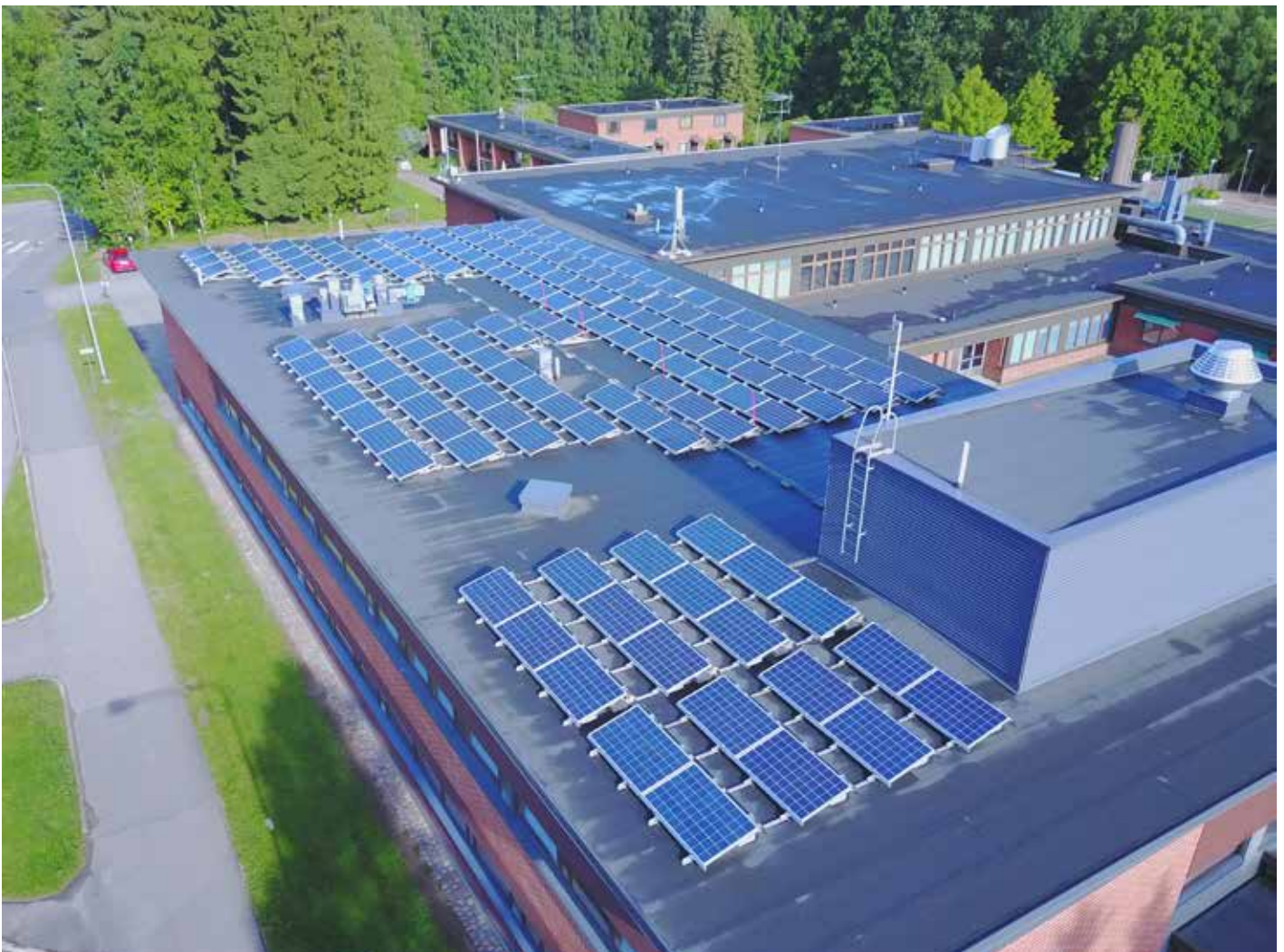
Riihikallion koulun katolle asennettiin vuonna 2017 aurinkosähkövoimala. Kuva: Markus Palo
